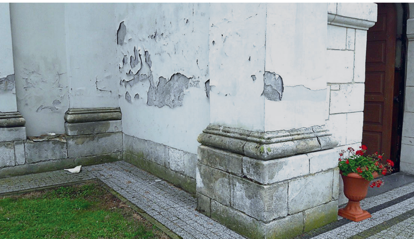
Fot. 1 Uszkodzenia wywołane podciąganiem kapilarnym.
