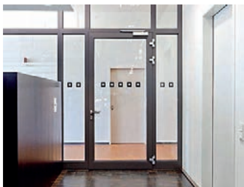
Fot. 9. Drzwi z samozamykaczem Dorma TS 93
