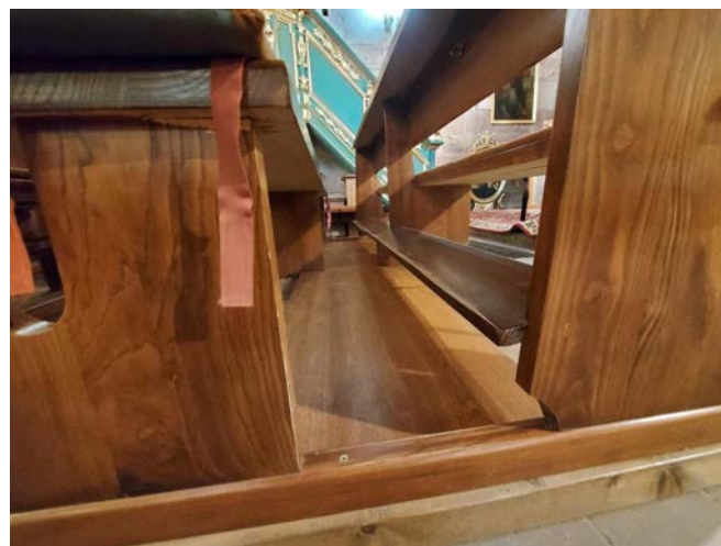
Panele grzewcze pod ławkami w kościele pw. św. Idziego Opata w Tarczku
