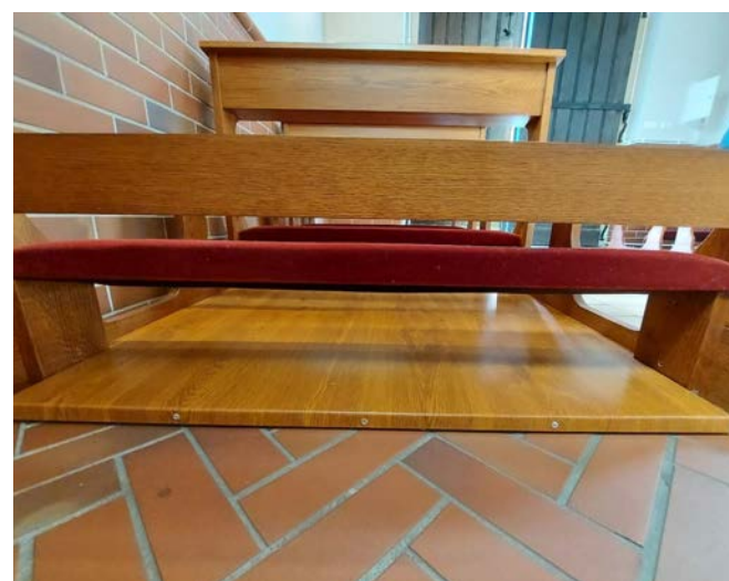
Podłogowe panele grzewcze pod ławkami kaplicy przy kościele pw. św. Wawrzyńca w Rudzie Śląskiej
