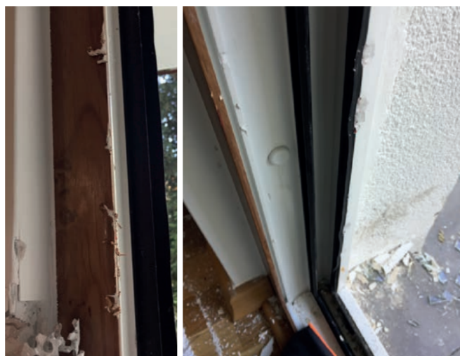
Widoczna na zdjęciach skala uszkodzeń profili nie pozwoliła na naprawę okien. Firma MS więcej niż OKNA zaoferowała jednak właścicielowi nową stolarkę w promocyjnej cenie, a także dużo krótszy okres realizacji zamówienia.
