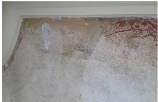
A01. Stan zachowania tynków i śladowo warstwy malarskiej.
